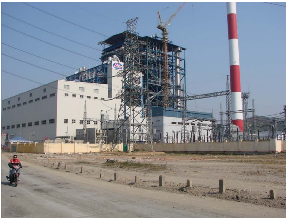
Рис. 3 Фотография котла ТПЕ-318/СО ТЭС Уонг-Би (Вьетнам)
