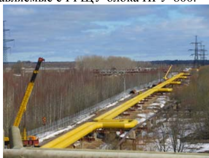
Рис.4. Подводящие газопроводы на промышленной площадке Киришской ГРЭС
