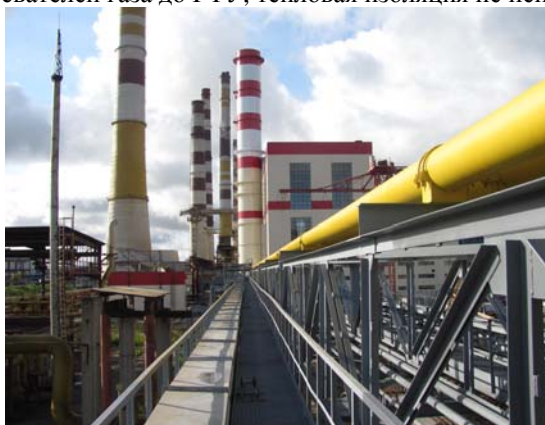
Рис.10. Газопровод к корпусу ПГУ-800 на эстакаде.
