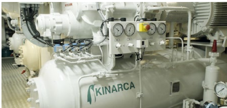
Компрессорные агрегаты KINARCA холодопроизводительностью 280 кВт (-40...+35°C) на траулере Argos Cies
