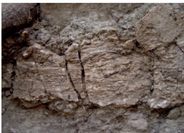
Рис. 1.35. Остатки известковой штукатурки со следами затирки поверхности травой.
