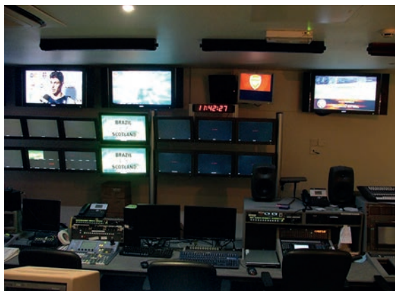
Фото 59. Единый центр управления стадионом (Великобритания, Лондон, стадион «Emirates Stadium»)
