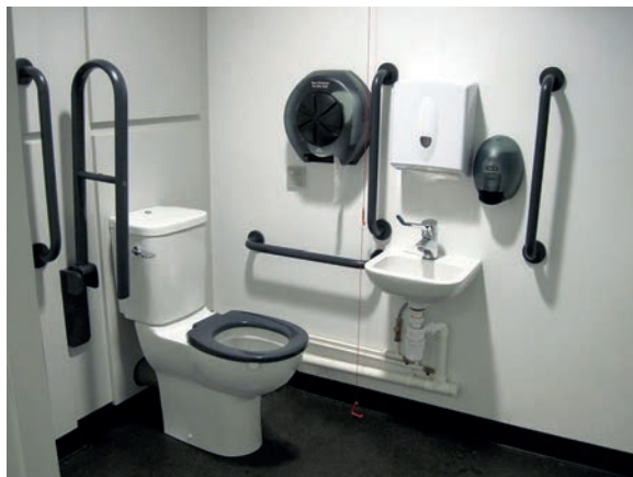
Фото 86. Оборудованный санузел для инвалидов
