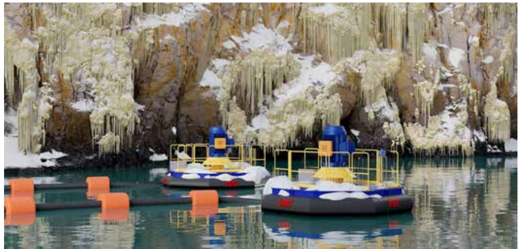
Sensorización de Bombas Cantiléver Flotantes
