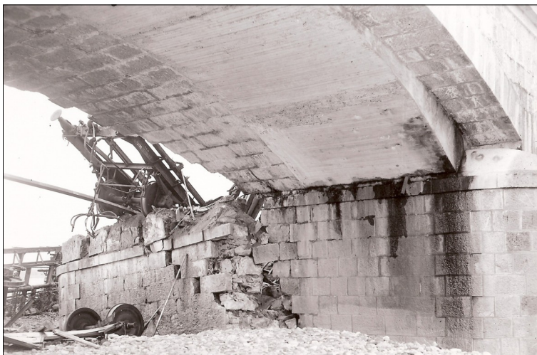
La pila scalzata dal Torre che causò il crollo del ponte del 22 novembre 1938. Si nota la volta in calcestruzzo armato dell'allargamento della sede stradale, probabilmente negli anni '20 (arch. FUC)
