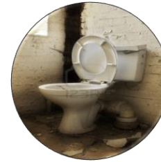
Toilette qui fuit
