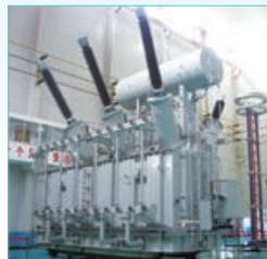
Auto Transformer (OSFSZ9 320000 230KV)
