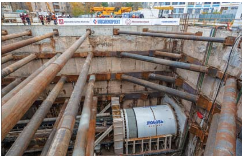
Начало щитовой проходки правого перегонного тоннеля между станциями «Лефортово» и «Авиамоторная» Большой кольцевой линии
