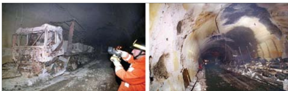
Рис. 2. Последствия пожара в тоннеле Монблан: а – сгоревший автомобиль, неисправность которого послужила причиной пожара; б – разрушение несущей конструкции тоннеля
