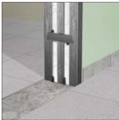
НЕСУЩИЙ ПРОФИЛЬ И УГОЛКИ УСИЛЕНИЯ ПРИВАРИВАЮТСЯ К ШТЫРЯМ ВБИТЫМИ В ПЛИТУ ПЕРЕКРЫТИЯ
