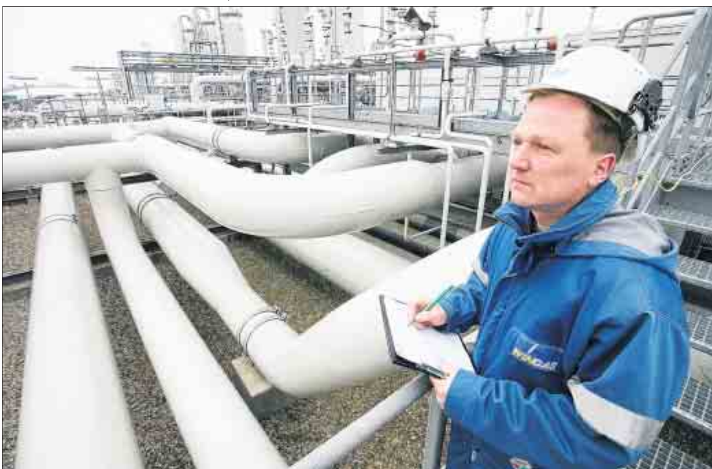
Erdgas-Verteilerstation: Noch immer herrscht wenig Wettbewerb auf dem Markt. Einfachere Durchleitungsregeln dürften das bald ändern. Foto: ddp
